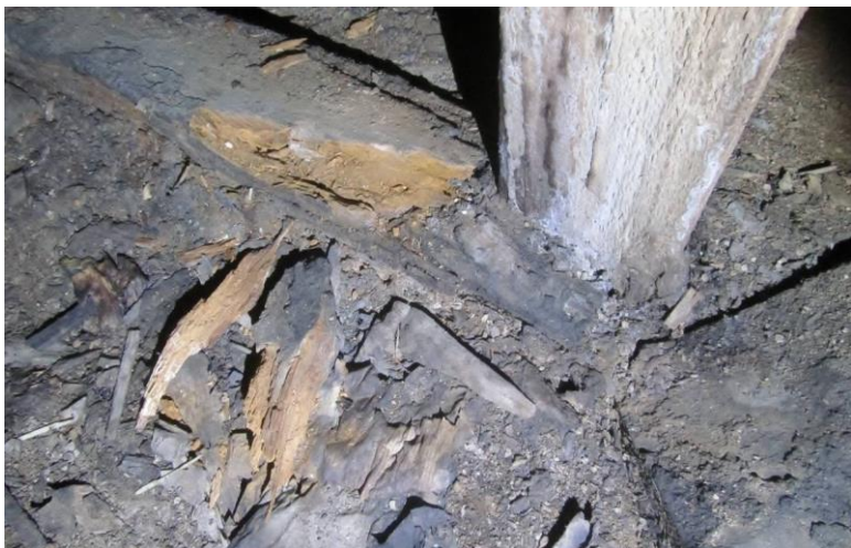
Satrupējušas jumta koka konstrukcijas - sijas
