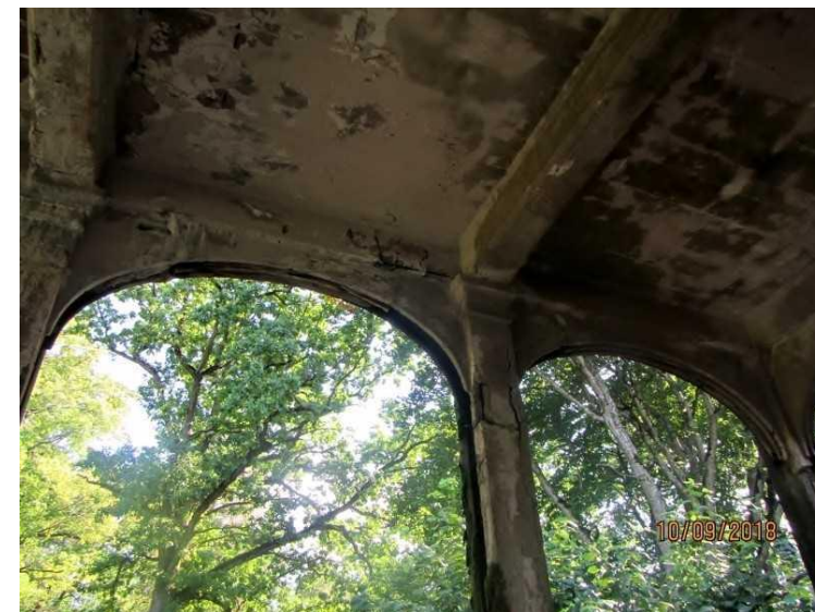
Dzelzsbetona kolonnu bojājumi (plaisa, armatūras korozija)
