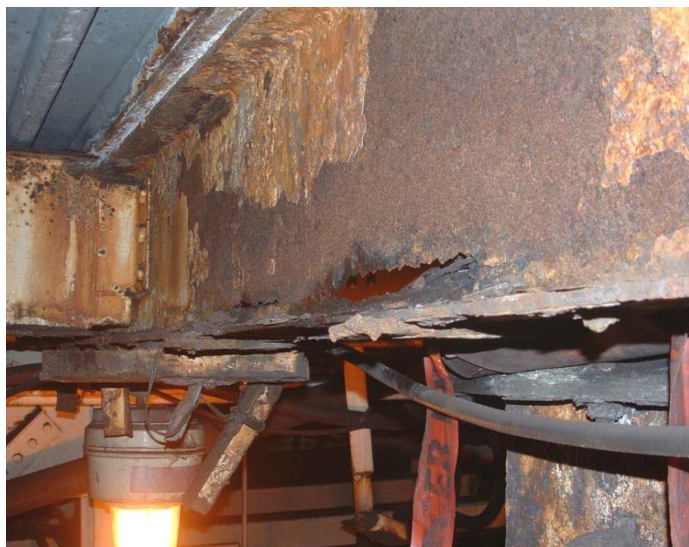
Tērauda sijas korozija
