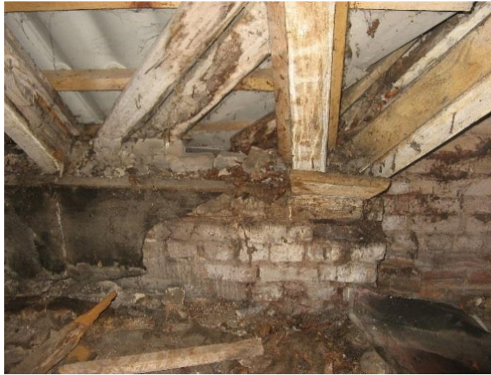
Drempeļa mūra sabrukums balstījuma zonā
