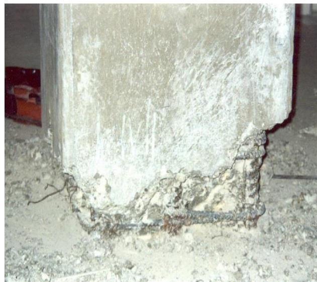
Dzelzsbetona kolonnas atšķēlumi pamatnē
