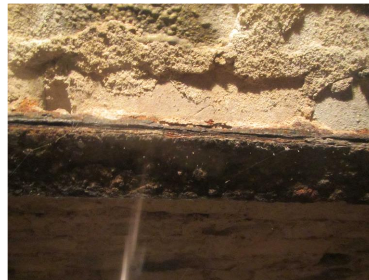
Tērauda sijas korozija, atslāņojumi
