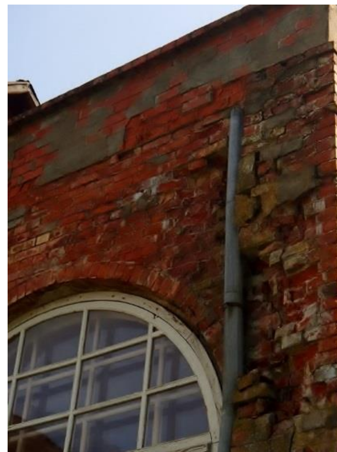
Mūra erozija ūdens notekas vietā
