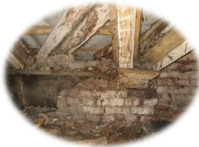
Drempeļa mūra sabrukums balstījuma zonā
