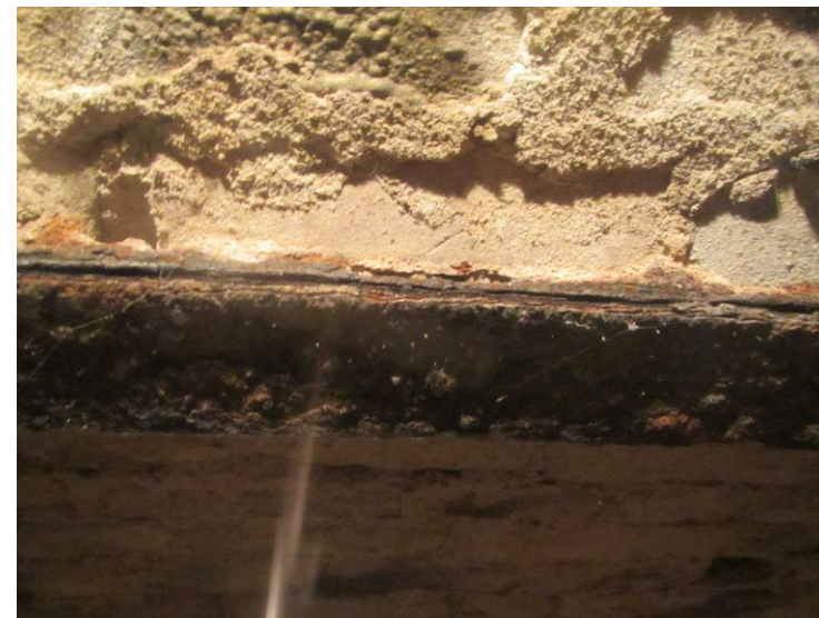
Tērauda sijas korozija, atslāņojumi
