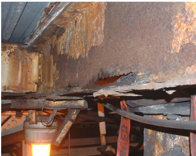
Tērauda sijas korozija
