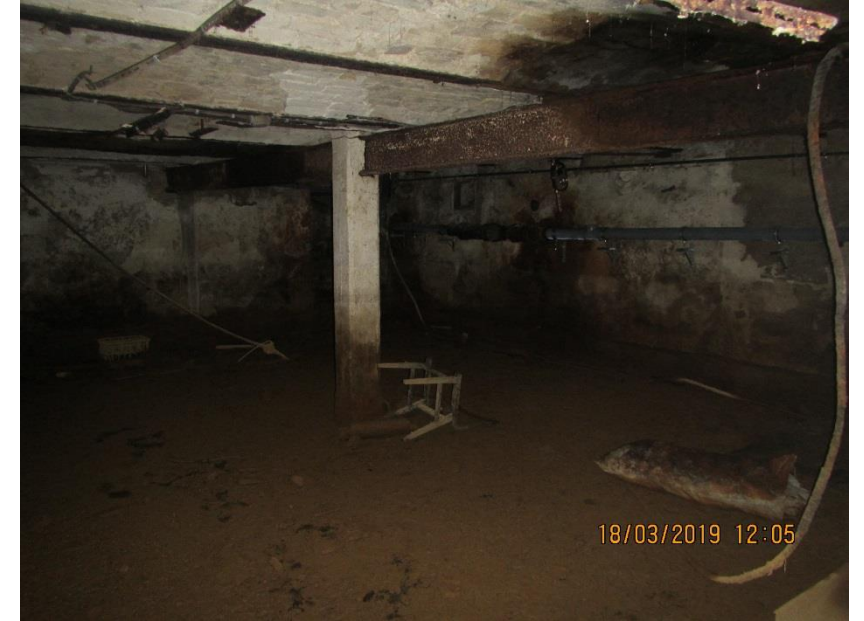
Paaugstināta mitruma ietekmē strauji progresē korozija
