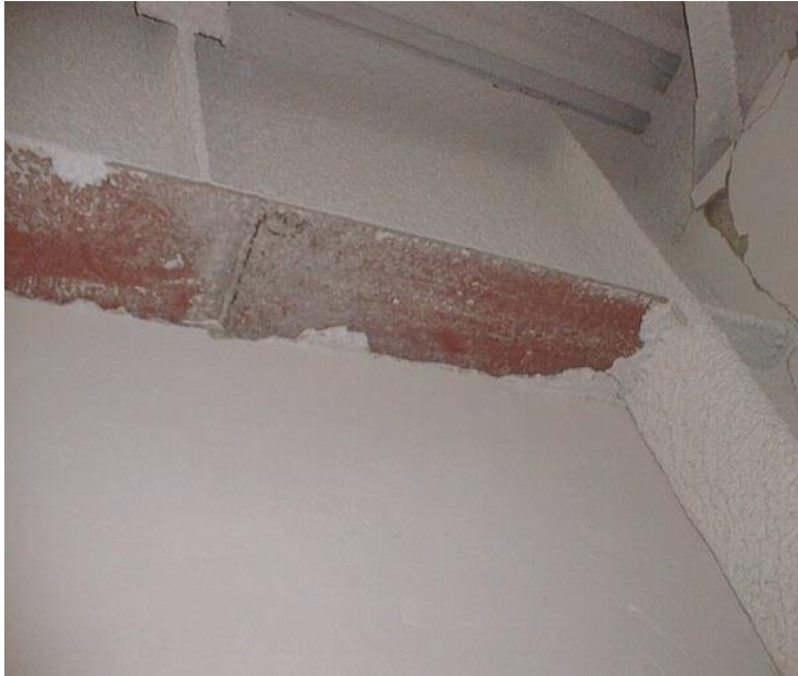
Neatbilstoša metāla konstrukciju izolācija
