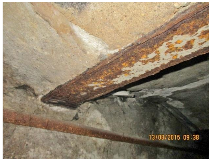
Pārseguma mūra velves balstošās sijas korozija
