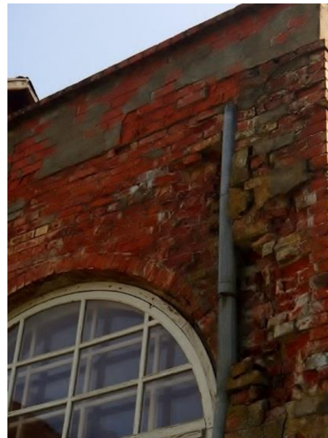
Mūra erozija ūdens notekas vietā
