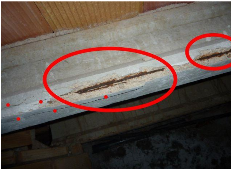
Stiegrojuma korozija un aizsargkārtas lokāla atslāņošanās
