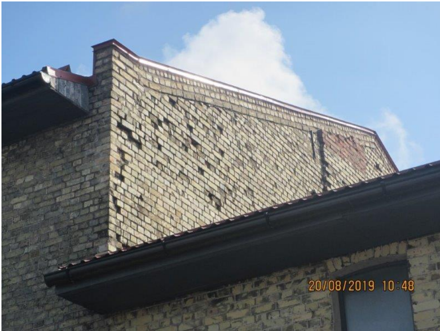
Atsevišķu mūra ķieģeļu erozija
