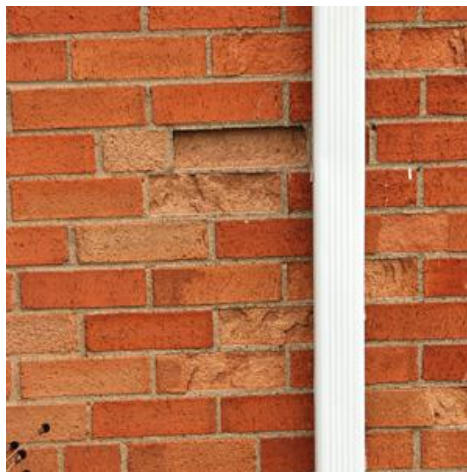
Mūra ķieģeļu erozija
