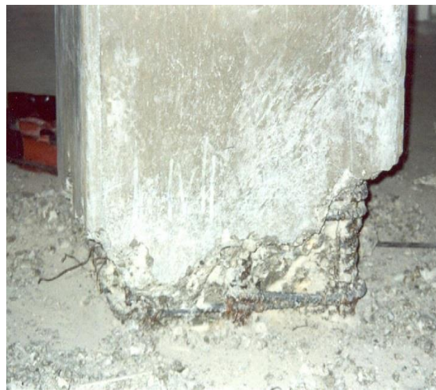
Dzelzsbetona kolonnas atšķēlumi pamatnē
