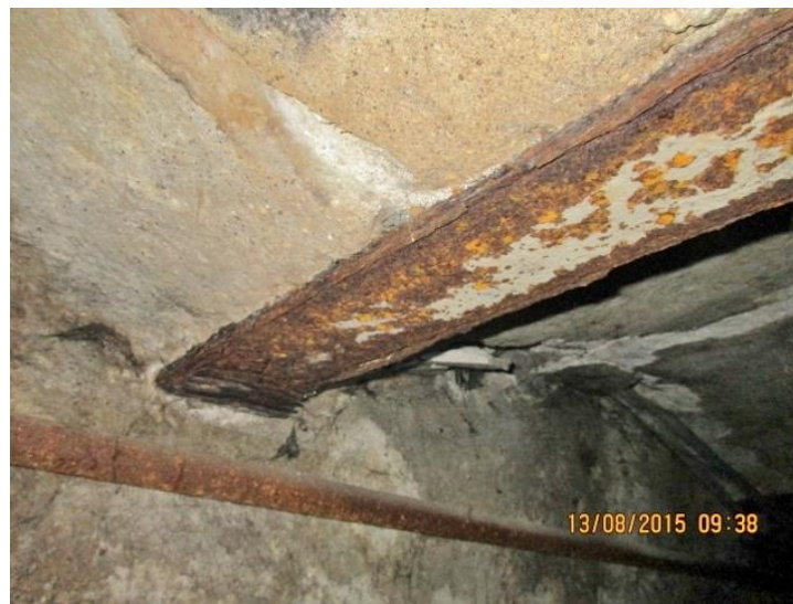
Pārseguma mūra velves balstošās sijas korozija
