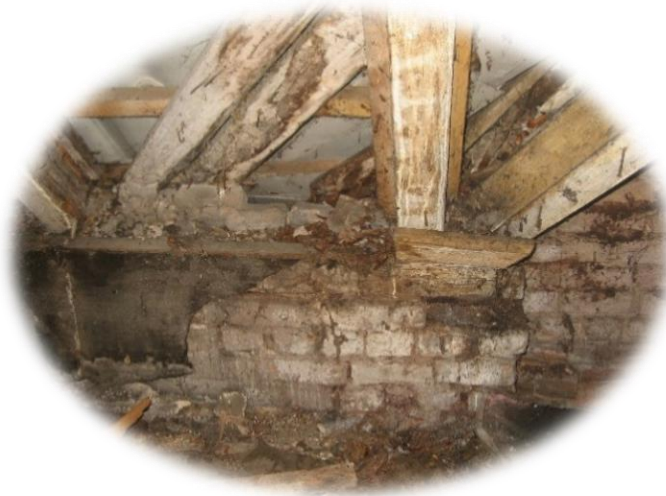
Drempeļa mūra sabrukums balstījuma zonā
