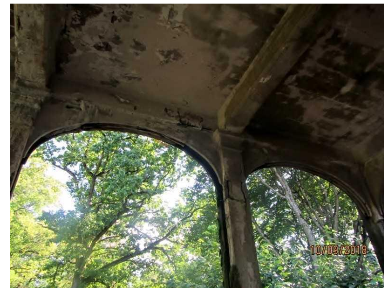
Dzelzsbetona kolonnu bojājumi (plaisa, armatūras korozija)
