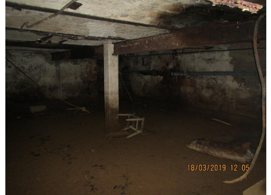
Paaugstināta mitruma ietekmē strauji progresē korozija
