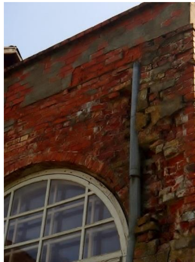
Mūra erozija ūdens notekas vietā
