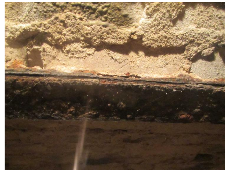
Tērauda sijas korozija, atslāņojumi
