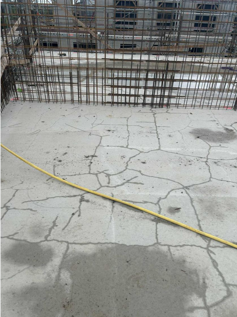
Plastiskā rukuma plaisas betona pārsegumā
