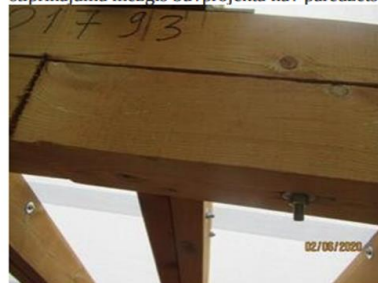
Koptura savienojums zem spāres ir veikts neatbilstoši būvprojektam (iztrūkst bultskrūvju savienojuma). Defektu akts un defektu novēršanas kārtība uzrādīta netika.
