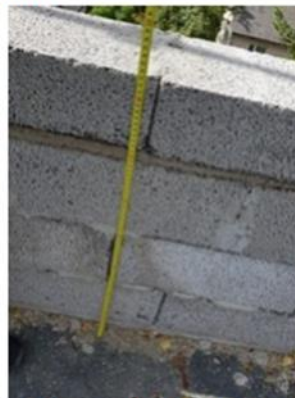
Keramzītbetona bloku mūra parapets 0.73 m no kores augstuma- neatbilst būvprojekta risinājumam.
