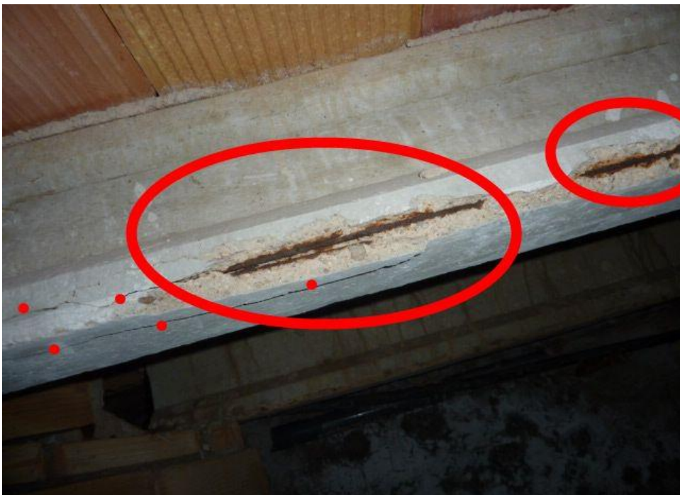
Stiegrojuma korozija un aizsargkārtas lokāla atslāņošanās
