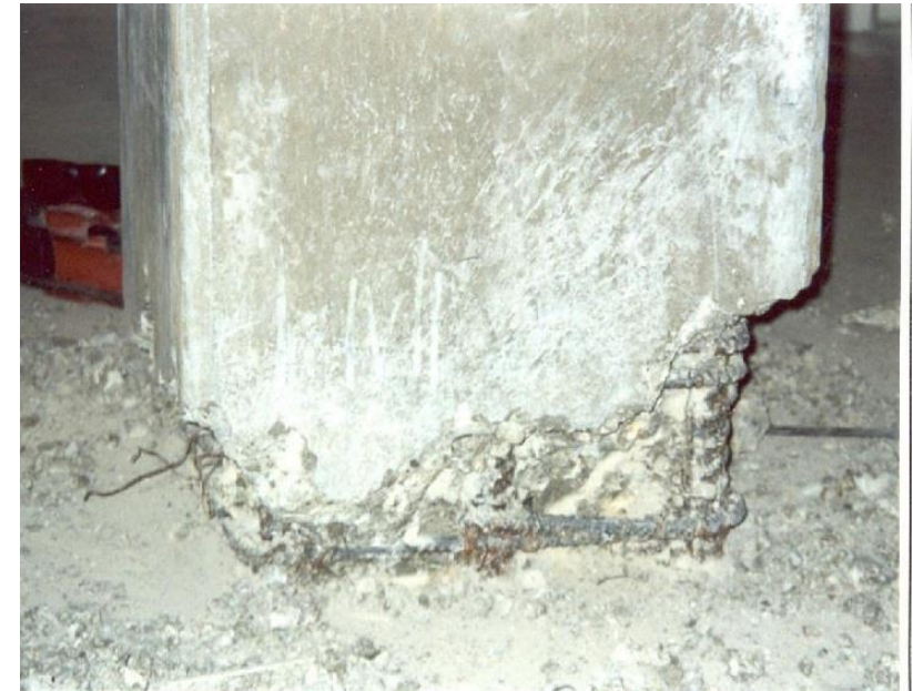
Dzelzsbetona kolonnas atšķēlumi pamatnē
