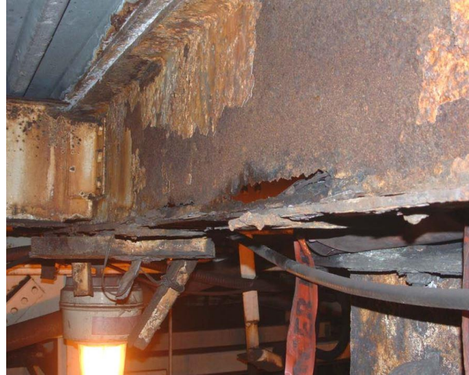
Tērauda sijas korozija
