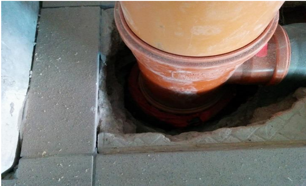
Komunikāciju šķērsojumu blīvējumi nav.
