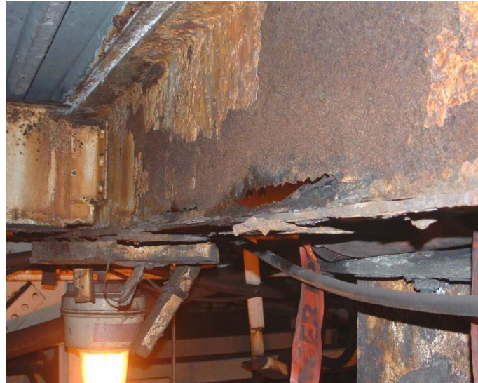
Tērauda sijas korozija
