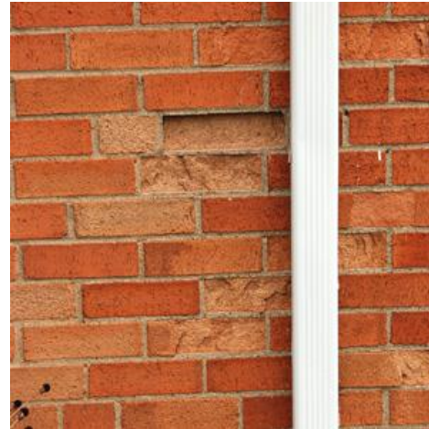
Mūra ķieģeļu erozija
