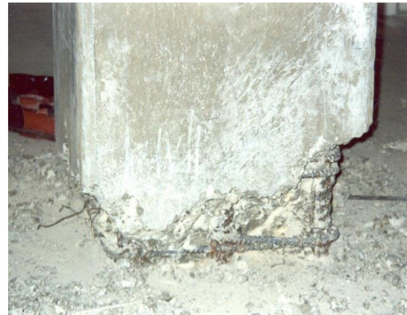
Dzelzsbetona kolonnas atšķēlumi pamatnē
